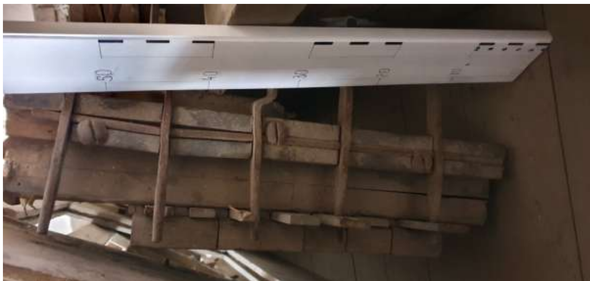
Ryc.: 85. Bok wiatrownicy – śruby i puszczalniki w tym brak dwóch. Fot. P. Lewko, 27.01.2024.
